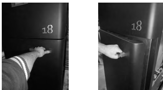
Figura 54 – Porta frontal da caldeira
